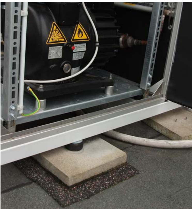
Bild 2: Die schwingungsdämmende Lagerung ist bei drehzahlgeregelten Anlagen von großer Bedeutung für den störungsfreien Betrieb über einen langen Zeitraum.
