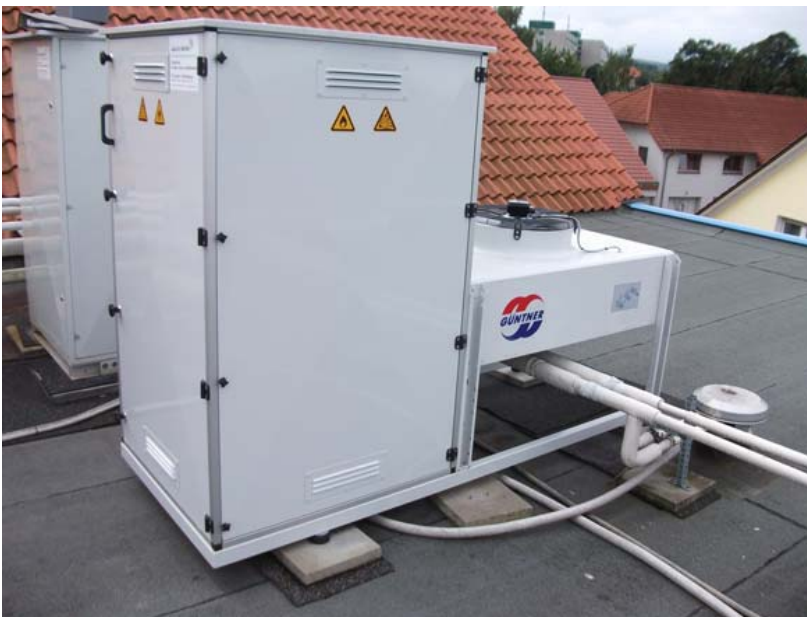
Bild 1: Der von der Fa. Schriefer gebaute Solekühler auf dem Dach der Stadtwerke Lübecke
